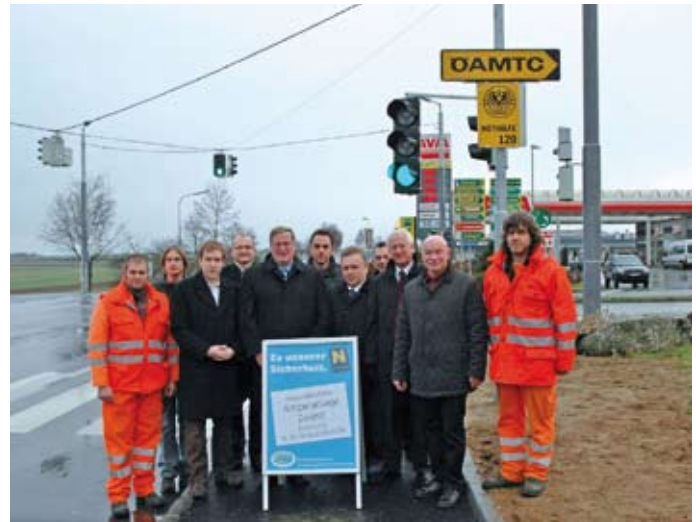
Am 11. Dezember wurde die neue Verkehrslichtsignalanlage im Kreuzungsbereich der Landesstraße B 38 und der Industriestraße von LABg. Franz Mold und Bgm. Herbert Prinz in Betrieb genommen.
